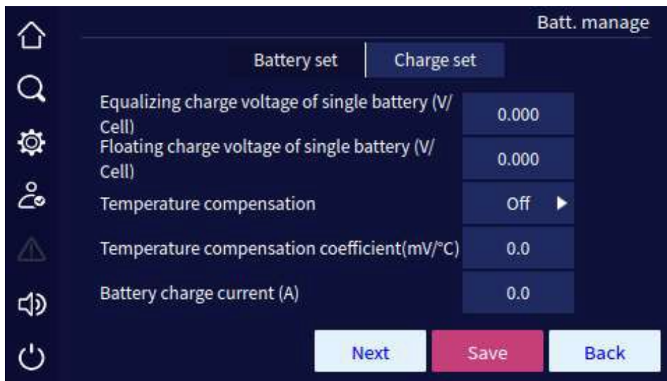
Рис 4.32 Настройка заряда АКБ 1
